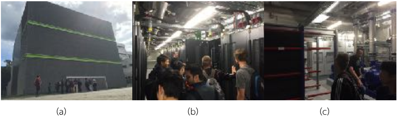
รูปที่ 1.4 (a) อาคาร Green Cube (b) วิทยากรกำลังบรรยายเกี่ยวกับห้องเซิร์ฟเวอร์ (c) ภายในห้องควบคุมระบบทำความเย็น
