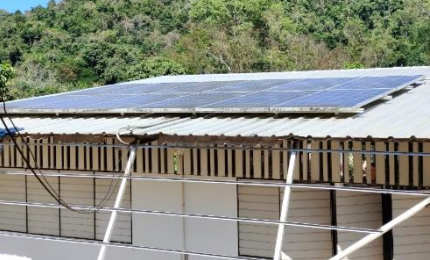
ชุดแผง Solar cell 3kWp (12 แผง)
