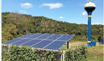
ชุดแผง Solar cell 3.2kWp (10 แผง)
