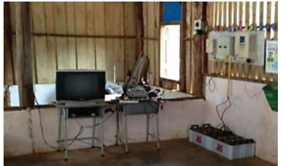
อุปกรณ์ไฟฟ้า และระบบผลิตไฟฟ้าพลังงานแสงอาทิตย์ แบบ Stand Alone ที่มีขนาดกำลังไฟฟ้าสูงสุด ๔๘๐ วัตต์ (Wp) ของโครงการระยะที่ ๑ (พ.ศ. ๒๕๕๑ - ๒๕๕๔)
