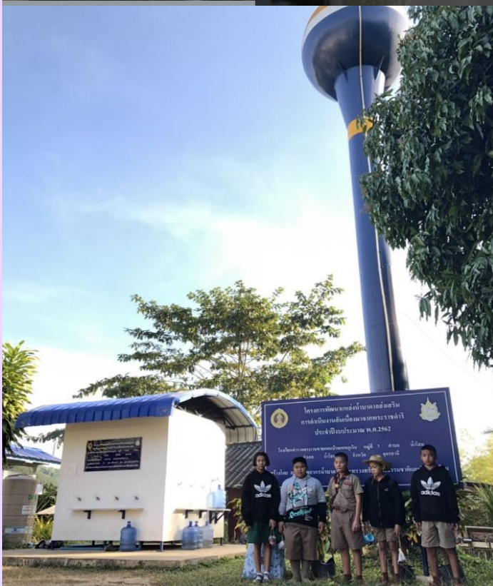
อาคารบ้านน้ำดื่มพร้อมติดตั้งระบบปรับปรุงคุณภาพน้ำ ระบบ Ultra Filtration (UF) กำลังการผลิต ๒๕๐ ลิตรต่อชั่วโมง
