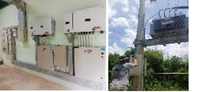
ปรับปรุงระบบใหม่เมื่อปี 2563 PV On-grid system แบบมี Diesel Gen. เป็น Backup
