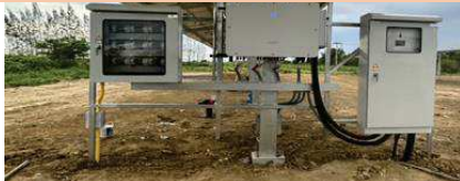
อินเวอร์เตอร์ DC/AC Combiner box และตู้ควบคุมระบบไฟฟ้าของระบบ PV เฟส 2
