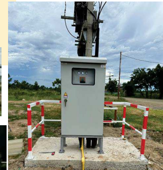
ตู้ควบคุมไฟฟ้าของอาคารอำนวยการ อาคารเรียนรวม และโหลดอื่นๆ (ภายใต้มิเตอร์ หมายเลข 21501231) ซึ่งเชื่อมต่อกับไฟฟ้าที่ผลิตได้จากระบบ PV เฟส 2
