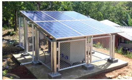
Solar cell 1.5kWp สำหรับโรงเรียนขนาดเล็ก
